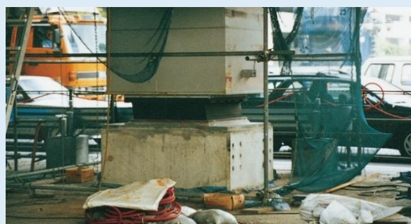
⑤ 橋脚下端に設置された免震支承
