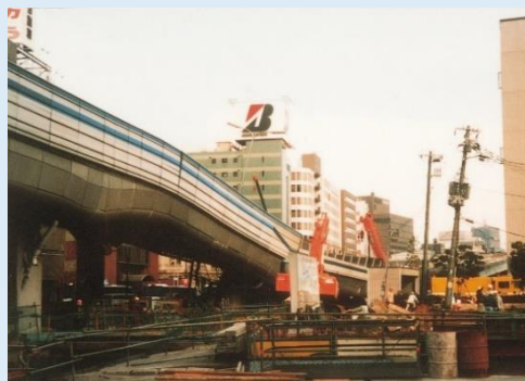
② 被災状況（平成7年1月）
