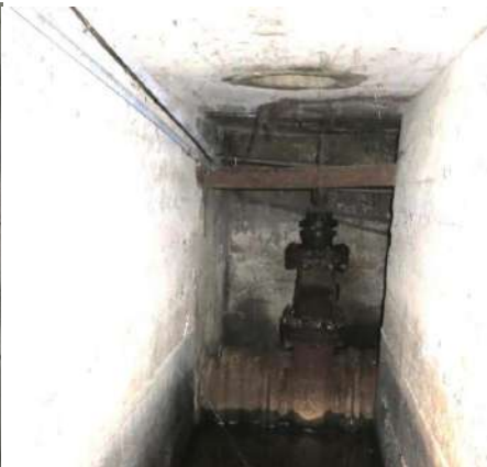
建物地下を走る送水管
