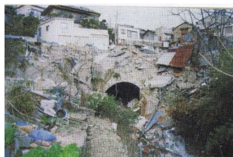
写真-4 吐口坑門の被災状況 6)
