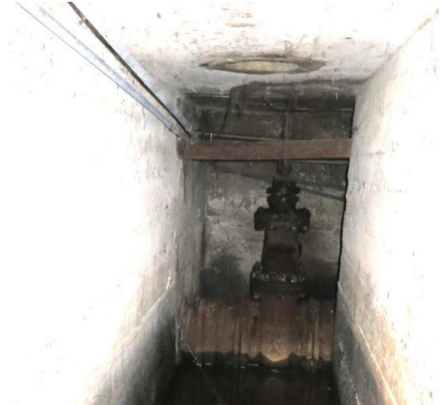
地下の送水管
