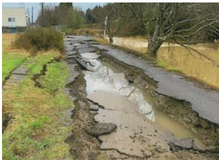
写真-2 導水管の埋設道路の損傷（珠洲市）
