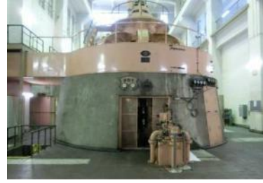
第三期蹴上発電所の内部(水車発電機)
