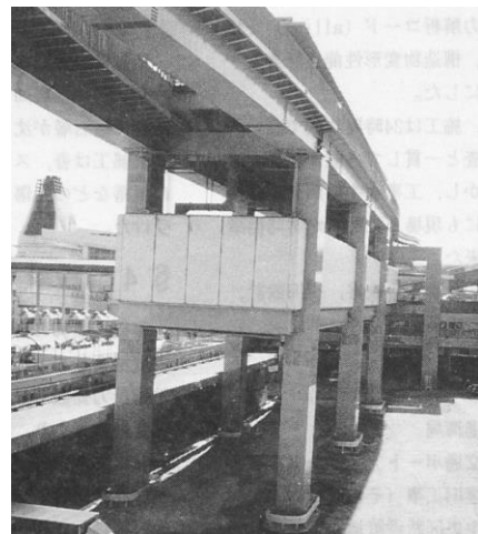
図1 被災したポートターミナル
