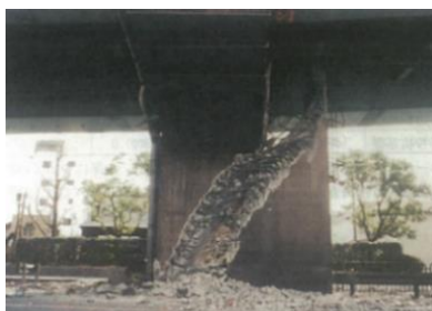
写真-5 RC 橋脚のせん断損傷
