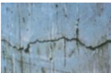
写真-2 RC橋脚梁部のASR によるひび割れ
