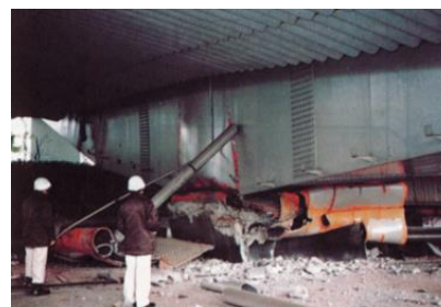
写真-6 鋼製橋脚の圧壊損傷
