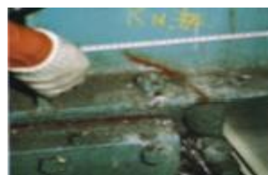
写真-3 ソールプレート取付け部 の溶接部のき裂
