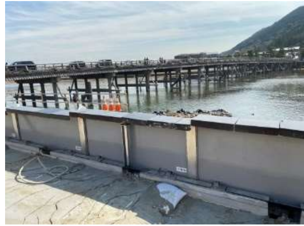
可動式止水壁
