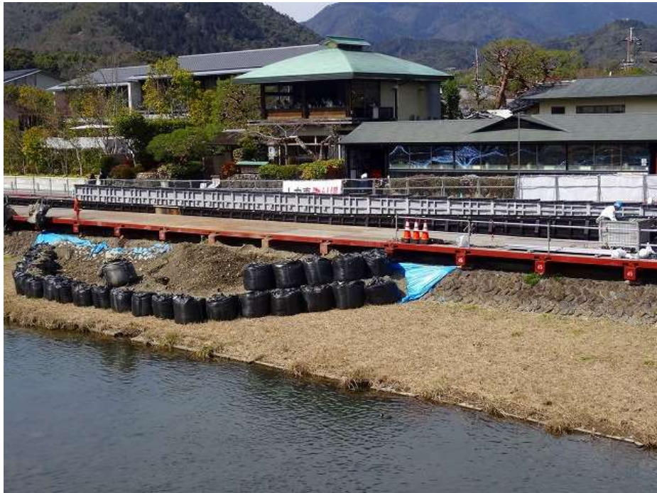
氾濫対策の可動式止水壁
