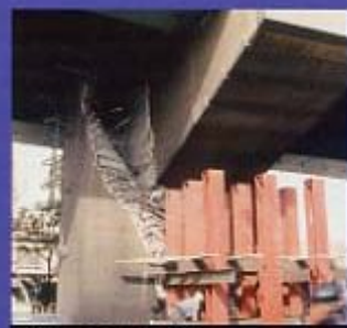
神P-240のせん断破壊 Damages on P-240
