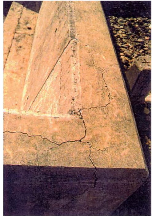
(謎の骨材捜しは、このひび割れから(昭和57年))
