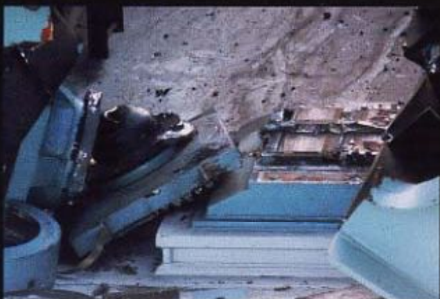
ピボットローラー支承の破壊 Failure of pivot roller bearing
