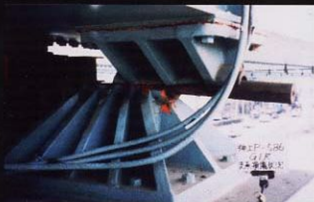
ピン支承の抜け出し Excessive pin displacement
